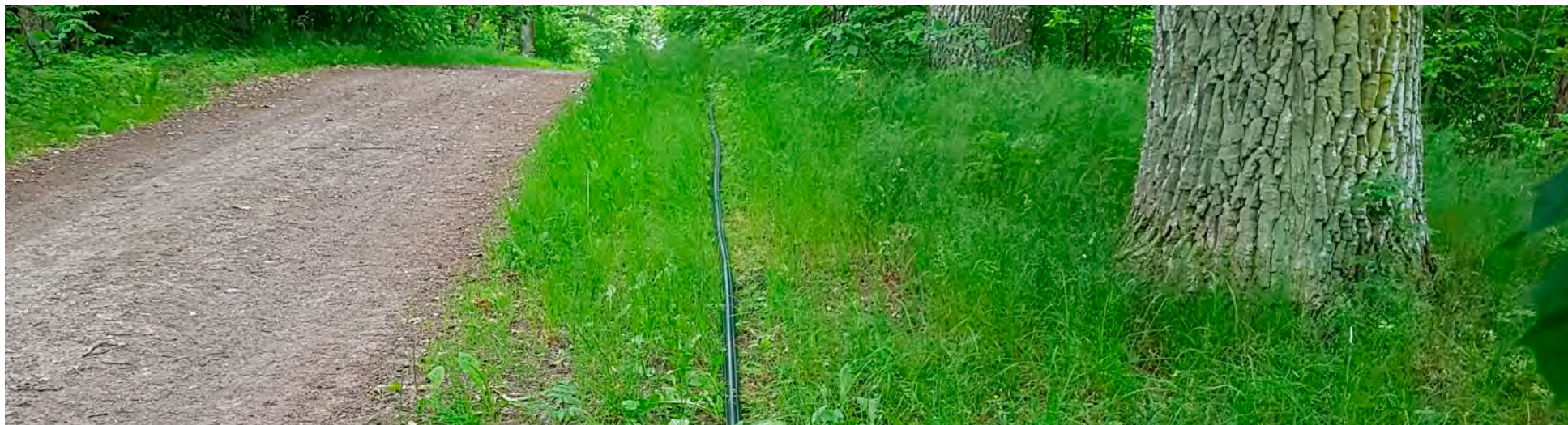
Att arbeta med dricksvattnet på långsikt är en viktig fråga och ett prioriterat område här läggs en ledning med dricksvatten ut när brunnen sinade på Tureholm
